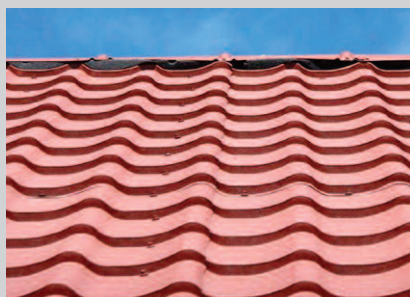
Fot. 4. Profilowana uszczelka podgąsiorowa do blachodachówek była sprzedawana jako ważny element systemu, ale nikt nie informował o konieczności wentylowania pokrycia
