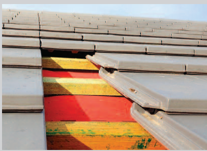
Fot. 6. Wypchnięta przez termoizolację (wełnę) MWK wypełnia przestrzeń utworzoną przez kontrłaty, co uniemożliwia przepływ powietrza wentylującego. Jest to obecnie bardzo częsty defekt spowodowany popularnością pian typu OKPUR
