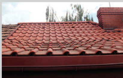
Fot. 5. Wysoki pas dorynnowy w okapie dachu pokrytego dachówką jest typową wadą wykonawczą w Polsce. Są regiony, w których od trzydziestu lat wykonuje się tak dachy, a dachówki mają najczęściej taki okres gwarancji
