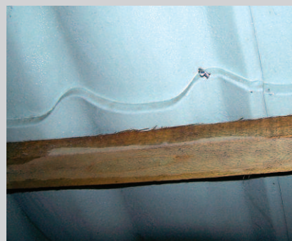
Fot. 1. Skroplina pod niewentylowaną blachodachówką powstaje zawsze w dużej ilości z powodu braku wentylacji tego pokrycia. To skutek zastosowania uszczelkek w okapie i pod gąsiorami, takich, jak na fotografiach 3 i 4
