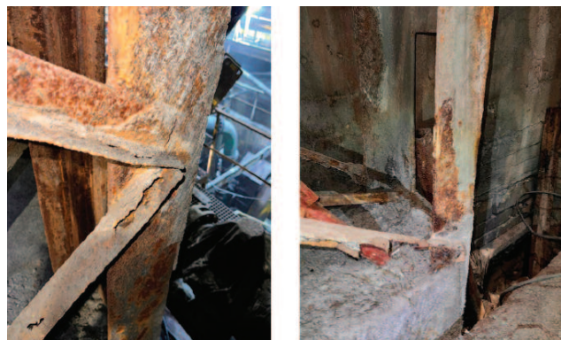
Photo 1. Corrosion of pole cross-arms and bracing Fot. 1. Korozja gałęzi i skratowań słupów
