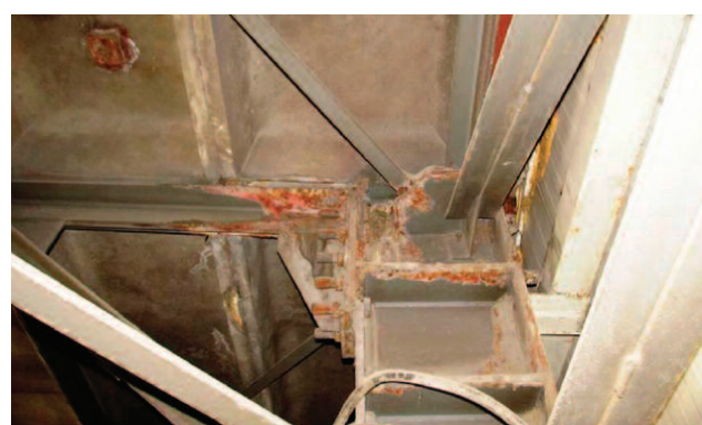
Photo 2. Corrosion of girder structural connections Fot. 2. Korozja węzłów konstrukcyjnych dźwigarów
