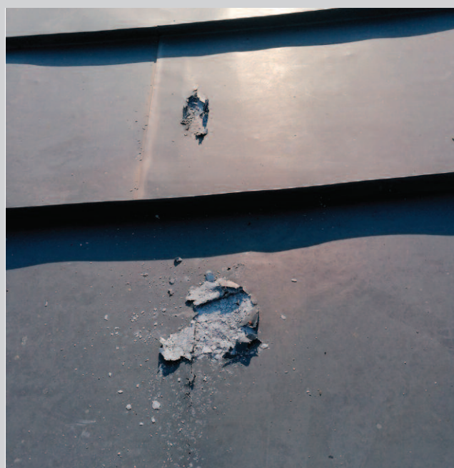
Fot. 3. Dach z fotografii 2. Gromadzenie się wody pod pokryciem blaszanym spowodowały błędy polegające na braku wentylacji nad membraną, która dodatkowo miała spełniać funkcję warstwy poślizgowej i dlatego stykała się z blachą cynkową
