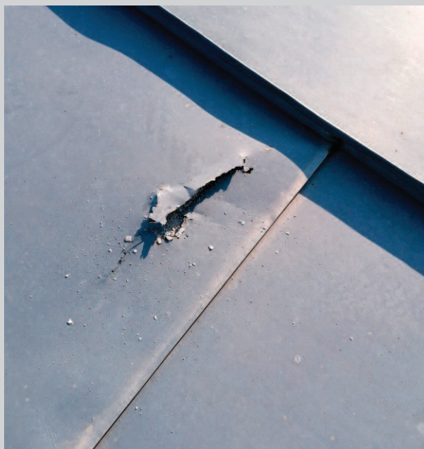
Fot. 2. Po trzech latach od ułożenia wystąpiła na tym dachu perforacja spowodowana działaniem gorącej wody, powstałej ze zgromadzonej pod blachą skroplonej pary wodnej, która dostała się tam, przechodząc z wnętrza dachu przez MWK ułożoną bezpośrednio pod blachą cynkową
