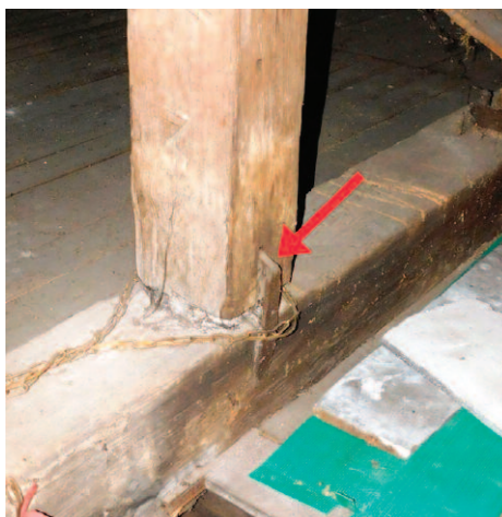
Photo 6. Joint of the king post with the main beam Fot. 6. Połączenie wieszaka z nadciągami
