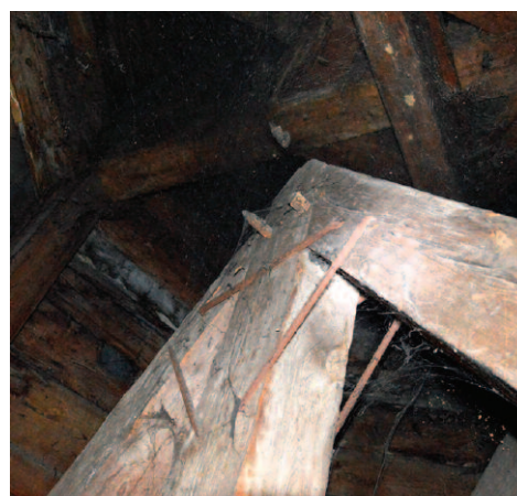
Photo 1. Joint of the king post with the rafters Fot. 1. Połączenie wieszaka z krokiewiami
