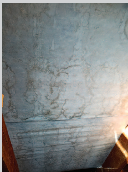
Fot. 1. Zacieki solne na MWK, nad którą jest pokrycie z blachodachówki. Widać powtarzalność wzorów utworzonych z zacieków. Wynika to z kształtu profilu pokrycia, pod którym na jego spodzie (pod wgłębieniem) gromadzi się najwięcej skroplin
