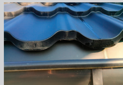
Fot. 3. Dach pokryty płaską blachodachówką modułową. Widać wadliwe wykonanie okapu w postaci kieszeni (basenu) utworzonej z MWK, w której stoi woda i gromadzi się sól z impregnatów spływająca razem ze skroplinami. Po odparowaniu (w dół przez MWK) wody pozostają zacieki solne
