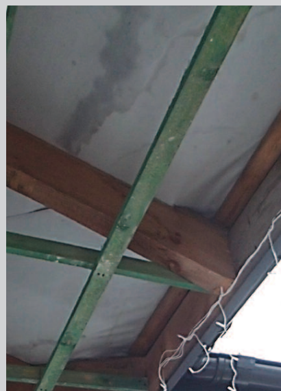
Fot. 2. Zacieki solne na MWK, nad którą jest pokrycie z blachodachówki modułowej. Zaciek jest bardzo wyraźny i pojedynczy co sugeruje istnienie wgłębienia w pokryciu i brak jego wentylacji
