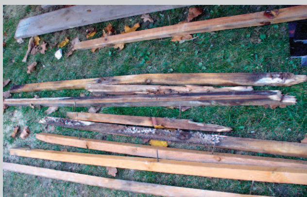
Fot. 6. Łaty zdemontowane z połaci pokazanej na fotografii 5. Po pięciu latach wiele listew znajdujących się pod kalenicą należało usunąć (ostatnie 3-4 poziomy)
