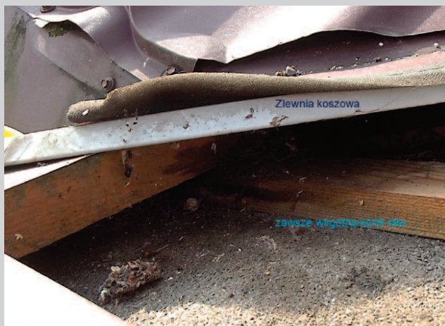
Fot. 1. Odkrywka dachu po szesnastu latach. Okap przy koszu. Widać zawilgoconą kontrłatę i początki jej butwienia
