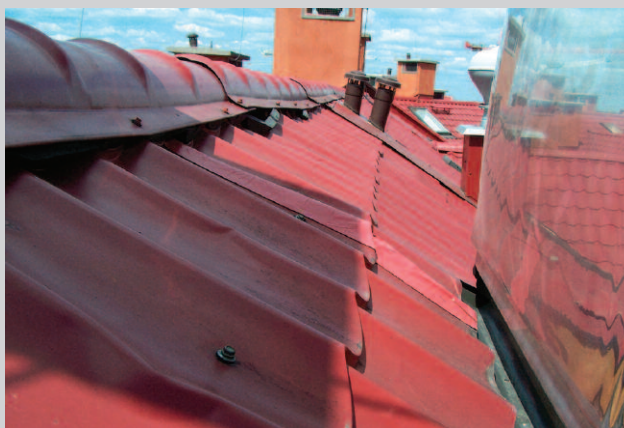
Fot. 4. Dach budynku wielorodzinnego przed remontem; wady ułożenia pokrycia
