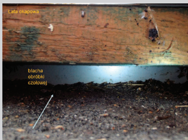
Fot. 2. Dach z fotografii 1 z widokiem na obróbkę czołową z blachy stykającą się z papą, jak na rysunku 1
