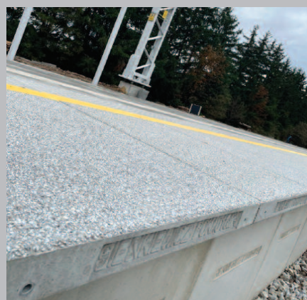
Fot. 7. Ścianki peronowe i płyty peronowe z odkrytym kruszywem
