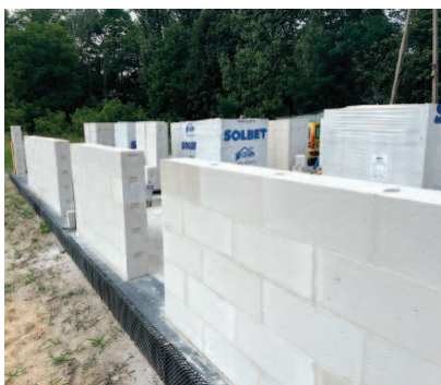
Fot. 2. Spoiny w murze z ABK
