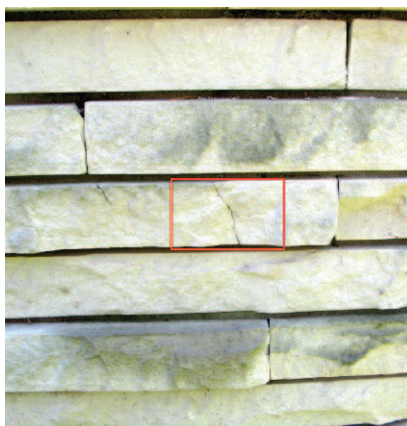
Photo 5. Damaged elements in the layered wall Photo: O. Kopyłow Fot. 5. Uszkodzone elementy w murze warstwowym Fot. O. Kopyłow
