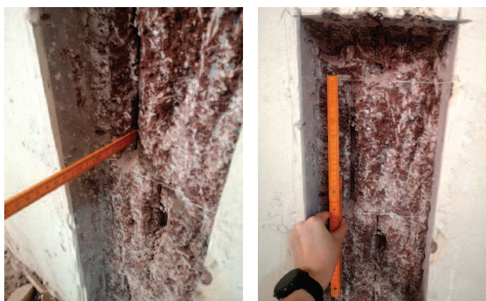
Photo 2. Examples of chasing walls with unfilled horizontal joints Fot. 2. Przykłady bruzdowania z niewypełnioną spoiną poziomą
