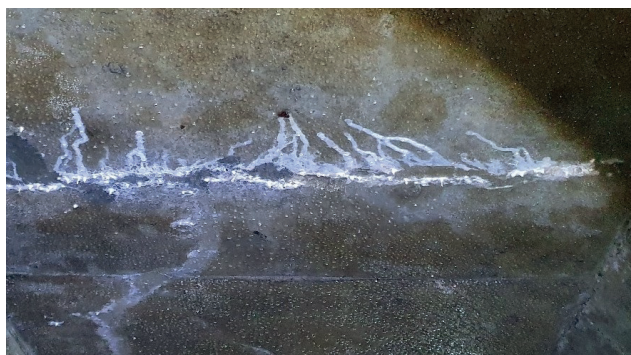
Photo 3. Water leakage – leakage of the material structure Fot. 3. Przecieki wody – nieszczelność struktury materiału
