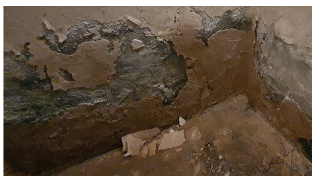
Photo 4. Surface chemical damage Fot. 4. Powierzchniowe uszkodzenia chemiczne
