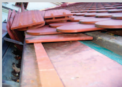
Fot. 4. Kratka wentylacyjna zamocowana nad pasem dorynnowym z blachy miedzianej jest tylko podporą dla dachówek. Powietrze dociera do końca tej obróbki, gdzie dachówka styka się z nią i zamyka przepływ. Brak wentylacji pokrycia
