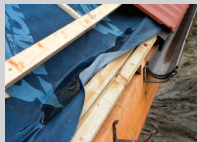
Fot. 1. Kieszka z MWK w okapie wypełniona wodą deszczową. Mimo takiego widoku wykonawca kontynuował pracę. Nie zastanowiło go, co stanie się z wodą. Brak wlotu dla powietrza oznacza brak wentylacji pokrycia
