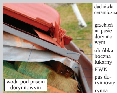
Fot. 2. Duża kieszka z FWK, ale popełniono podobne błędy, jak w przypadku z fotografii 1. Woda spływa po FWK i trafia pod pas dorynnowy, co pogarsza działanie okapu. Brak wentylacji pokrycia, gdyż nie ma wlotu dla powietrza
