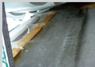
Fot. 3. Zamarznięta skroplina w kieszeni usytuowanej za łatą podtrzymującą rynajzy (haki z płaskownika). W dzień woda się topi i wpływa w każdą szczelinę, a w nocy skroplin przybywa i nad ranem zamarza. W ten sposób codziennie jest ich więcej
