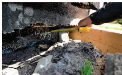
Fot. 2. Częściowo spalona izolacja termiczna pod płytą fundamentową Photo 2. Partially burnt thermal insulation under the foundation slab
