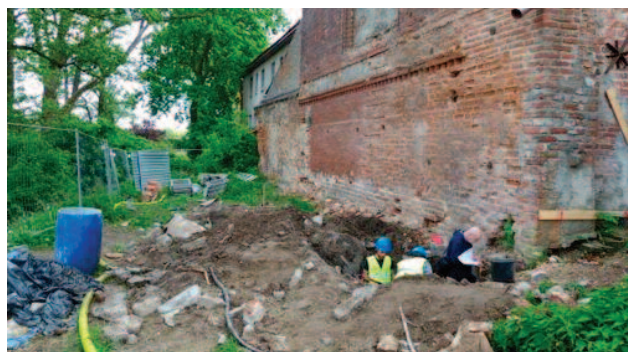
Fot. 2. Prace mające na celu wzmocnienie fundamentów [13] Photo 2. Works aimed at strengthening the foundations [13]
