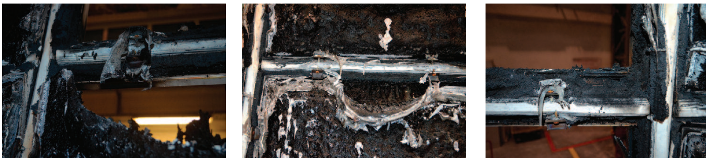
Fot. 3. Widok ściany od strony nagrzewanej po badaniu odporności ogniowej – detale Photo 3. View of the wall from the heated side after fire resistance testing – details
