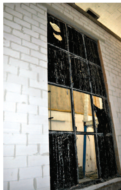
Fot. 2. Widok ściany od strony nagrzewanej po badaniu odporności ogniowej Photo 2. View of the wall from the heated side after the fire resistance test
