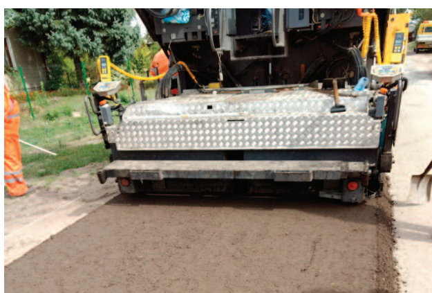
Fot. 2. Wykonanie podbudowy z mieszanki mineralno-cementowo-emulsyjnej modyfikowanej miazgiem gumowym Photo 2. Making of the base course from a mineral-cement-emulsion mixture modified with rubber powder
