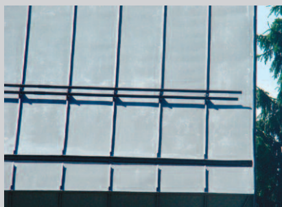
Fot. 3. Nierównomierne przebarwienia na pokryciu dachu z blachy cynkowej
