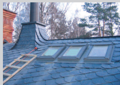
Dach w końcowej fazie układania płytek łupkowych. Połączenie pokrycia z wystającymi lub przechodzącymi przez pokrycie elementami jest indywidualnym wzorem opracowanym przez dekarza
