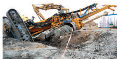
Fot. 2. Awaria wiertnicy spowodowana jakością platformy roboczej Fot. PZWFS Photo 2. Drilling rig failure caused by quality of working platform Photo: PZWFS
