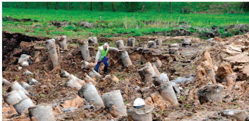
Fot. 1. Przykład awarii kolumn w wyniku wykonywania robót w sąsiedztwie wzmocnienia podłoża
