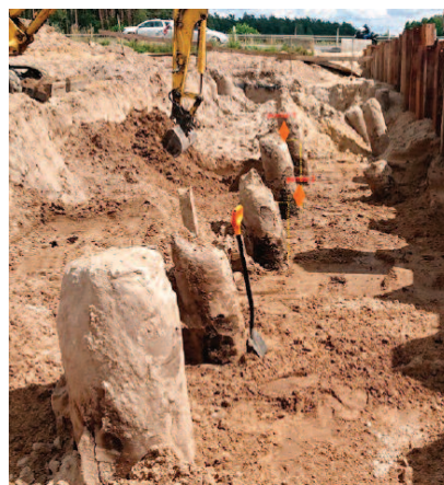
Fot. 4. Efekt wykonania zbyt płytkiej obudowy wykopu oraz ścięcia podłoża wraz z kolumnami
