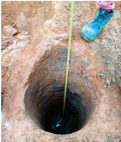
Fot. 3. Obniżenie się poziomu głowic po wykonaniu kolumn Fot. Menard Photo 3. Concrete slumping after execution of rigid inclusion Photo: Menard
