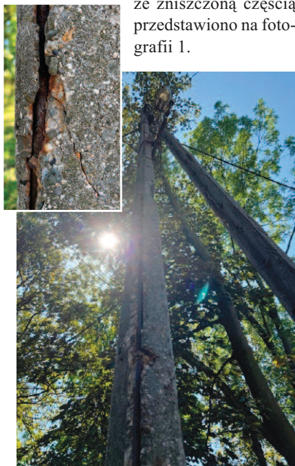
Fot. 1. Żelbetowy słup energetyczny niskiego napięcia – zniszczenie słupa w wyniku korozji
