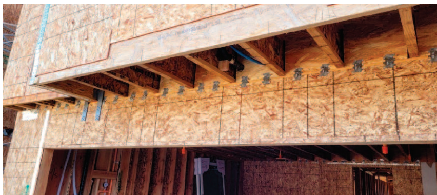
Fot. 3. Wykorzystanie blach stalowych do połączenia przekazującego siły ścinające pomiędzy konstrukcją stropu a ścianami parteru
