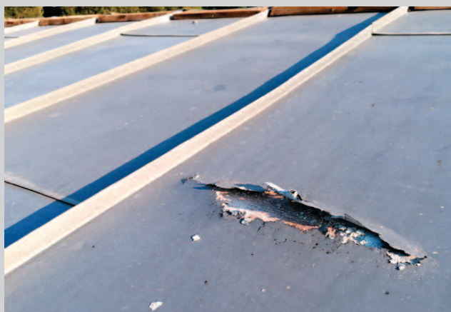
Fot. 3. Wadliwie wykonane pokrycie z blachy cynkowo-tytanowej. Pod pokryciem nie ma wentylacji ani warstwy poślizgowej. Na wypaczonych (maksymalnie zawilgoconych) deskach zbierała się woda, która w cyklach odparowywania i skraplania splukiwała węgiel cynku i uszkodziła blachę. Tak wygląda efekt „gorącej wody”
