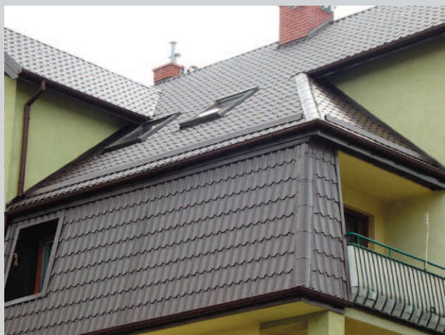
Fot. 2. Dach z mansardą pozorną, w której dolna część jest rodzajem elewacji wykonanej z tego samego pokrycia co dach budynku
