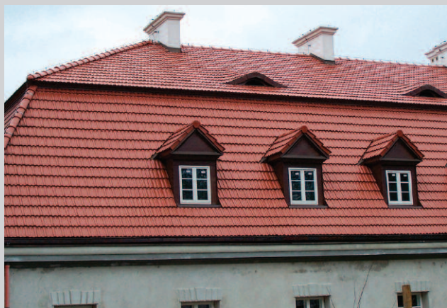
Fot. 1. Dach z mansardą właściwą z pokryciem opartym na jednej więźbie dachowej
