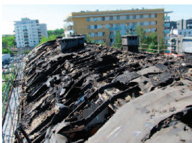
Fot. 2. Uszkodzony dach kolebkowy nad lokalami klatek VII i VIII Fot. Autorzy Photo 2. Damaged barrel roof over the premises of staircases VII and VIII Photo Authors
