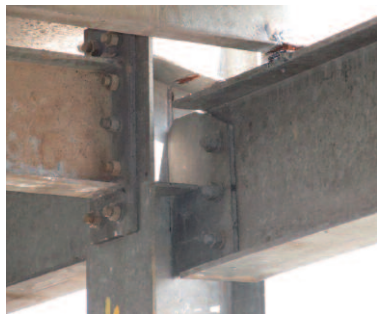
Fot. 1. Zerwany węzeł w poziomie stropu V kondygnacji
