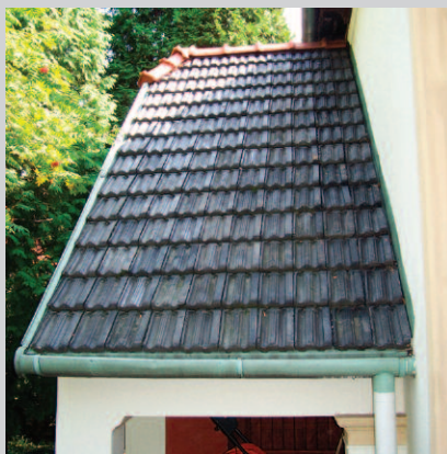
Fot. 1. Połacie dachowa siedziby firmy Marma Polskie Folie w Rzeszowie, na której leży stuletnia dachówka z Niepołomic nad membranę wstępnego krycia
