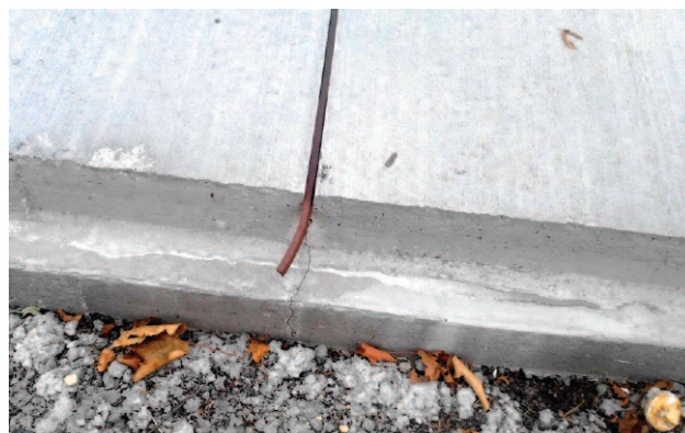
Fot. 3. Nacięcie dylatacyjne w nawierzchni betonowej Fot. Autor Photo 3. Expansion cut in the concrete surface Photo: Author
