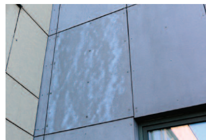
Fot. 1. Przebarwienia okładzin włóknisto-cementowych na elewacji wentylowanej Photo 1. Discoloration on fiber-cement claddings on the ventilated facade
