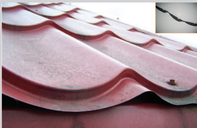
Fot. 1. Najczęściej popełniany błąd w okapie. Za wysoki pas dorynnowy zasłania wlot do szczeliny tworzonej przez kontrłaty. Kalenica jest też zamykana uszczelką
