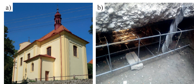
Fot. 4. Kościół św. Wacława w Dłazkovicach w Czechach: a) widok ogólny; b) wzmocnienie ławy fundamentowej Photo 4. St. Wencesla's Church in Dlazkovice, Czech Republic: a) general view; b) reinforcement of the strip footing
