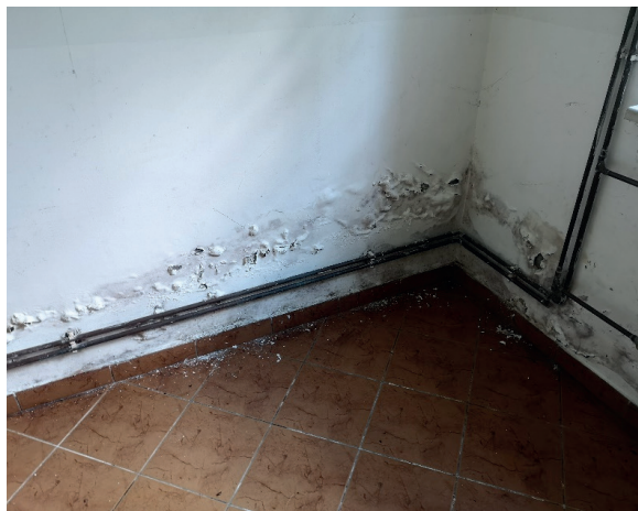
Fot. 2. Degradacja ściany zewnętrznej pierwszej kondygnacji obiektu 4 od strony zbocza Photo 2. Degradation of the outer wall of the first floor of building 4 from the slope side
