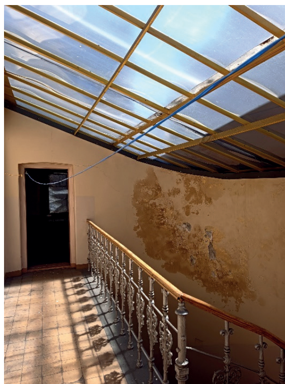
Fot. 1. Klatka schodowa najwyższej kondygnacji obiektu 3 z widocznym doświetleniem i wyraźnymi efektami degradacji spowodowanej działaniem wilgoci
