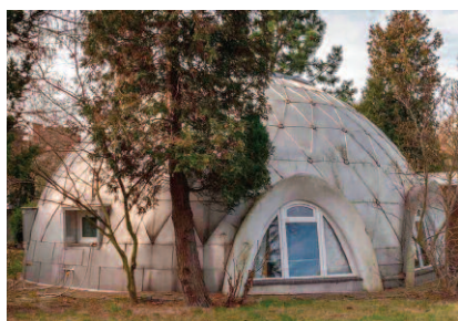
Fot. 3. Pokrycie kopuły budynku blachą aluminiową [2] Photo 3. Covering of the building dome with aluminum sheet [2]
