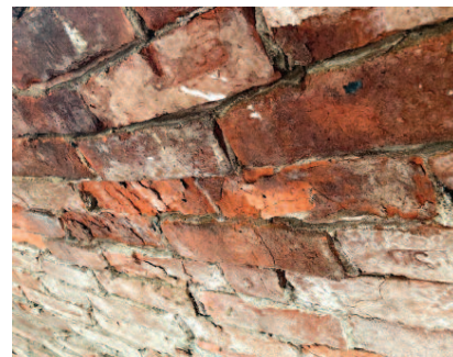
Fot. 6. Wgłębna korozja cegieł powłoki kopuły [4] Photo 6. Deep corrosion of the dome shell bricks [4]
