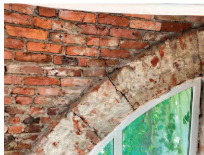
Fot. 4. Typowe zarysowanie łukowego nadproża okna [4] Photo 4. Typical cracking of arched window lintel [4]
