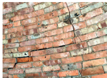
Fot. 5. Zarysowanie z przemieszczeniem łuku nadokiennego i kopuły [4] Photo 5. Cracking with displacement of the window arch and the dome [4]
