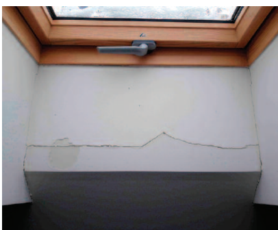
Fot. 6. Uszkodzenia styków płyt GKF przy oknie połaciowym Photo 6. Damage in the joints of the plasterboards at the roof window
