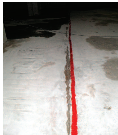
Fot. 3. Widok rysy rozchodzącej się liniowo, zlokalizowanej pomiędzy słupami
