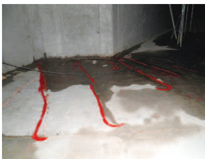
Fot. 2. Widok rys rozchodzących się promieniście od wklęsłego naroża płyty fundamentowej
