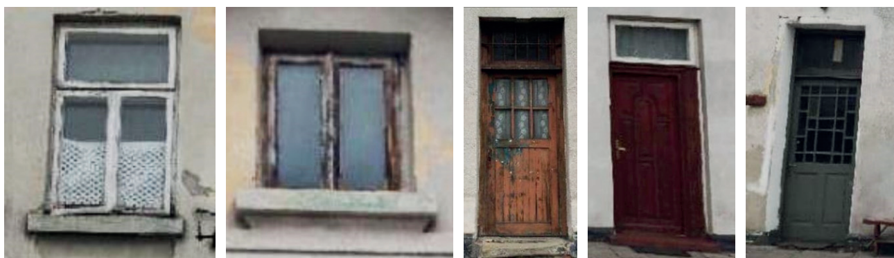
Fot. 2. Budynek dworca: uszkodzenia stolarki okiennej i drzwiowej Photo 2. Station building: damage to the window and door joinery
