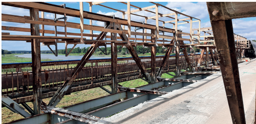
Fot. 2. Renowacja stalowych elementów konstrukcyjnych mostu Photo 2. Renovation of steel structural elements of the bridge
