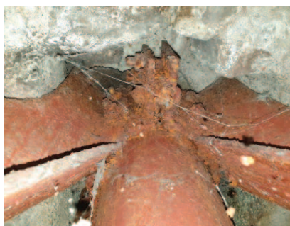
Fot. 2. Silna korozja zwornika górnego Photo 2. Strong corrosion of the upper keystone
