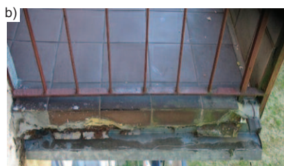
Fot. 4. Wadliwy montaż obróbek blacharskich na balkonach: a) w budynku zrealizowanym współcześnie; b) w budynku prefabrykowanym wzniesionym ponad 45 lat temu
