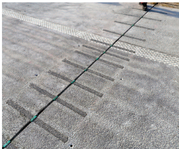
Fot. 3. Dyblowanie wtórne
