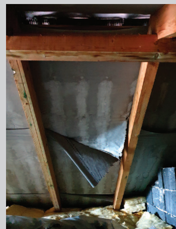
Strych został doświetlony oknem w szczycie budynku. Na MWK są zacieki soli z impregnatu, co zwiększa szybkość destrukcji spowodowanej przez UV. Dach ma ok. 5 lat
