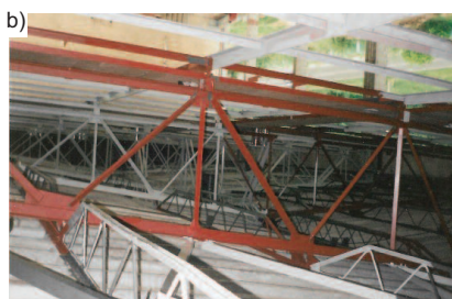
Fot. 1. Elementy konstrukcji dachu i rusztu stalowego: a) oparcie wiązara głównego na podporze; b) oparcie płatwi kratowych na wiązarach [8]
