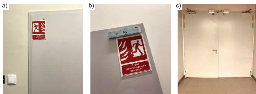
Fot. 5. Widok śruby przelotowej zamontowanej na wylot przez skrzydło drzwi (a); płyta magnetyczna przykręcona do skrzydła drzwi za pomocą śruby przelotowej (b); płyty magnetyczne do zwrót elektromagnetycznych przykręcone są do specjalnych uchwytników, dzięki czemu nie trzeba dziurawić skrzydła drzwi na wylot (c)
