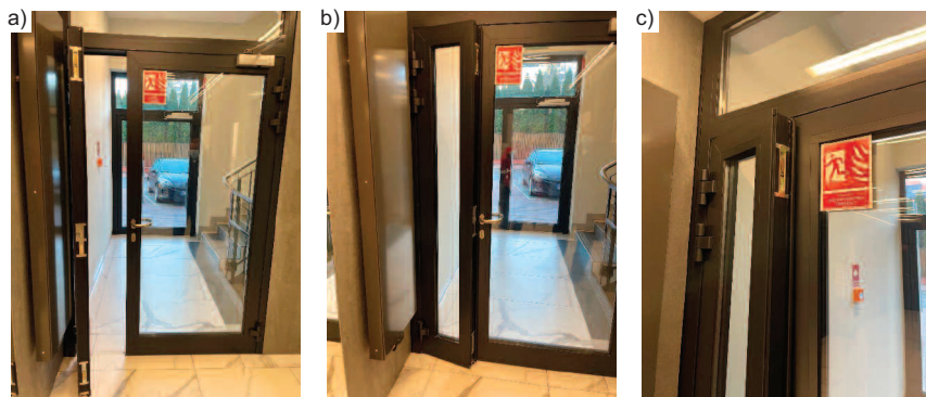
Fot. 1. Widok drzwi: a) gdy otwarte jest skrzydło bierne (nie ma mowy o wydzieleniu strefy pożarowej – w tym przypadku klatki schodowej); b) obrazujący zjawisko przelożenia się skrzydeł przez brak RKZ; c) ryglowanie skrzydła bierne – widoczne kantrygle przekładane są ręcznie, co w przypadku pożaru może być utrudnione
