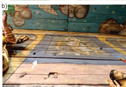
Fot. 3. Uszkodzenia ściany północno-wschodniej kościoła: a) wypaczenie się ściany (strzałkami zaznaczono kierunek deformacji); b) rozsuniecie elementów pełnego deskowania ściany
