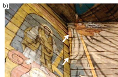
Fot. 4. Uszkodzenia wewnątrz kościoła: a) wybrzuszenie deskowania ściany południowo-zachodniej w obrębie sedillii (strzałkami zaznaczono kierunek deformacji); b) stan węglów pomiędzy ścianami drewnianymi w ich górnej części
