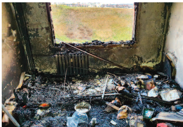
Fot. 2. Uszkodzenia wewnątrz budynku – pomieszczenie, gdzie zlokalizowano źródło pożaru
