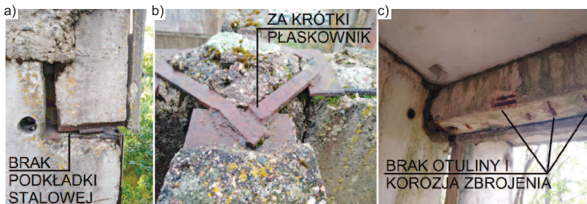
Fot. 2. Przykłady zaobserwowanych wad: a) brak podkładek; b) zbyt krótki płaskownik i spoiny; c) brak otuliny i korozja zbrojenia Photo 2. Examples of observed defects: a) lack of plates; b) flat bar and welds too short; c) lack of cover and corrosion of reinforcement
