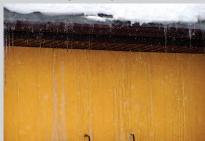
Fot. 2. Wielodniowy silny mróz w lutym 2010 r. ujawnił przewiew w okapie. Ciepłe powietrze przetransportowało parę wodną z wewnątrz przez szczeliny wokół murlaty
