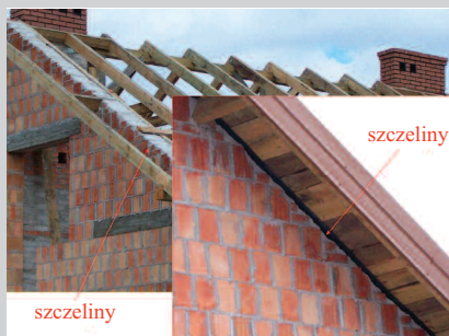
Fot. 5. Ściana szczytowa – wadliwe (bardzo częsty sposób) wykonanie zakończenia ściany. Szczeliny mają kilkucentymetrową wysokość, a czapka z zaprawy jest przysłanym mostkiem termicznym
