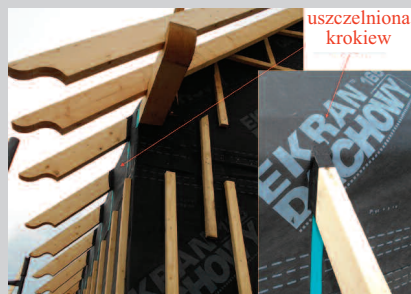
Fot. 1. Dom szkieletowy z krokiewmi dachowymi oklejonymi taśmami uszczelniającymi przyklejonymi do MWK połączonej szczelnie wiatroizolacją wykonaną z tej samej membrany (WMK)
