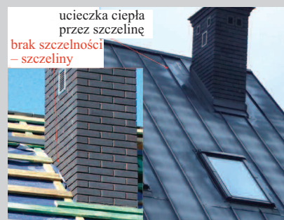
Fot. 3. Dach w czasie budowy i po ułożeniu pokrycia. Nieszczelne połączenie MWK z kominem powoduje ucieczkę ciepła, które ogrzewa szron na dachu
