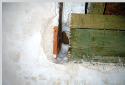
Fot. 4. Lukarna ze szczeliną pokazującą murlatę. W szczelinie znajduje się śnieg, mimo że na zewnątrz jest tynk. Przewiew zadziałał do środka budynku
