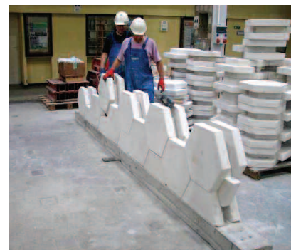
Fot. 6. Montaż „suchego muru” z warstwowych elementów murowych w ramach badań na Politechnice Śląskiej Fot. R. Jasiński Photo 6. Tests of „dry masonry” made of multi leaf masonry units carried out at the Silesian University of Technology
