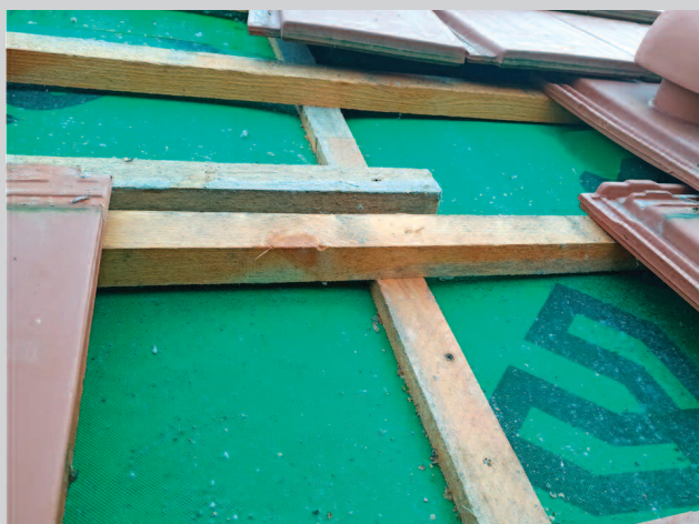
Za niska kontrłata (2,5 cm) i wypchnięta przez wełnę MWK spowodowały zablokowanie przepływu powietrza, powstanie pleśni na latach oraz zawilgocenie wełny. To bardzo często występujące w Polsce wady dachów
