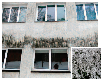
Fot. 3. Skażona biologicznie fasada z tynkiem typu „kornik” – podejmowane próby mycia myjką ciśnieniową nie przyniosły pozytywnego efektu
