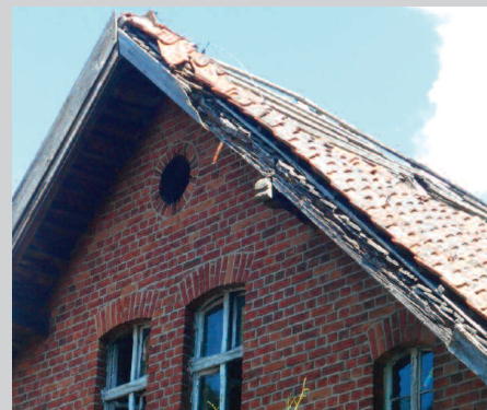
Fot. 1. Zrzucony dach budynku publicznego z poddaszem mieszkalnym, zbudowanego w drugiej dekadzie XX wieku. Pod dachówkami typu esówka jest warstwa wstępnego krycia wykonana z desek ułożonych na zakład. Fotografia wykonana w 2016 r.
