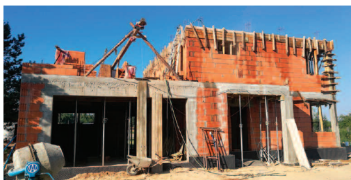
Fot. 2. Zawilgocenie wtórne struktury budynku w trakcie budowy następuje wiele razy
